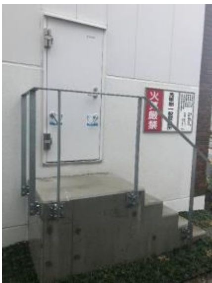
■ 塀に設けた防水扉
