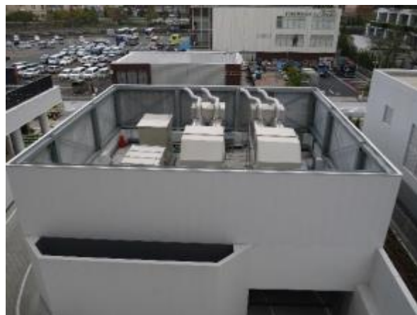
■ 電気設備の見下ろし
