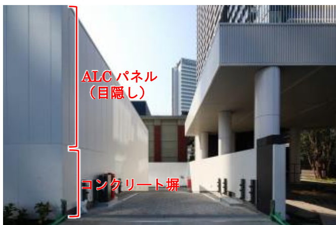
■ 電気設備周囲の塀
