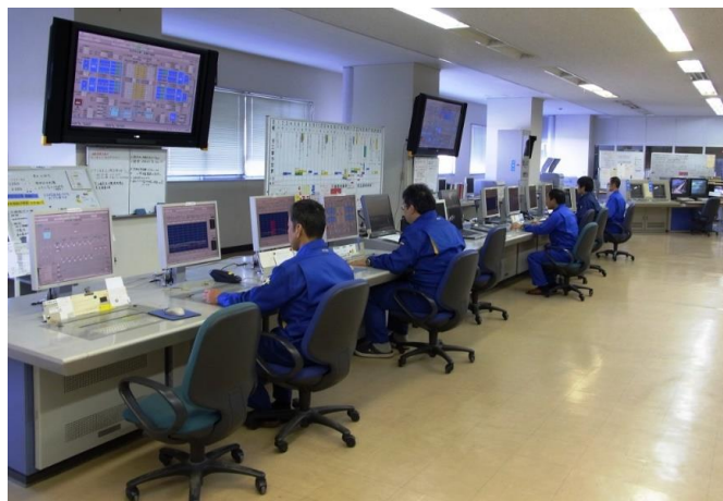
浄水場の管理室の様子
