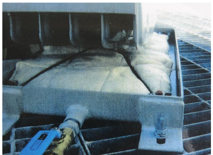
変電設備油漏れ使用例
