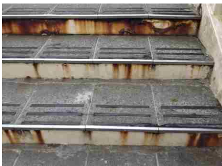
階段蹴上げ部補修前
