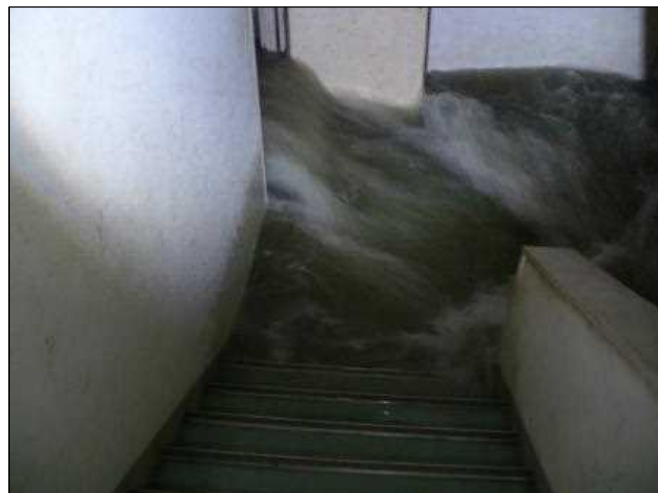
中継ポンプ場に下水が逆流し水没する様子
