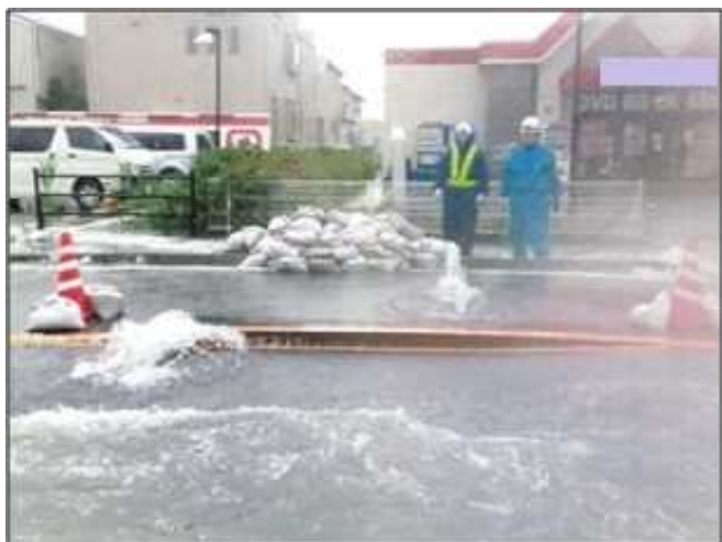
マンホールから下水があふれ出る様子 道路が破損し車が通行できない様子
