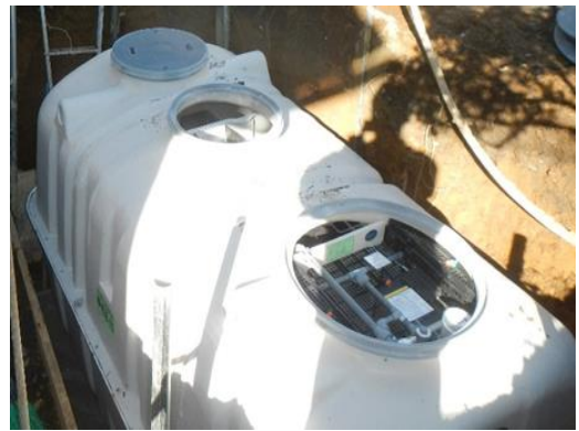
合併処理浄化槽
