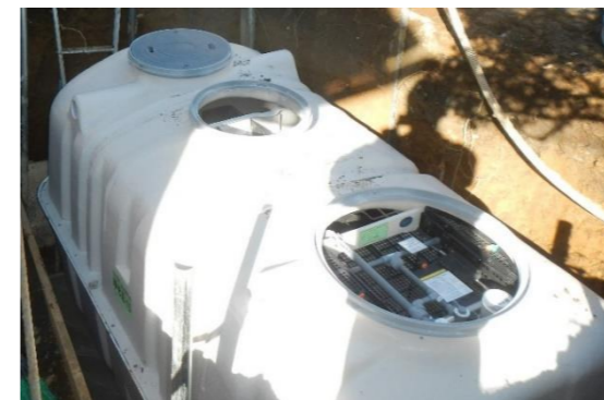
合併処理浄化槽
