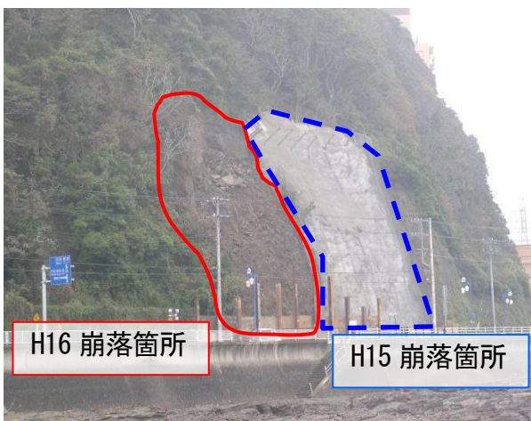
国道 128 号現道の法面崩落箇所
