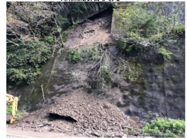
法面崩落状況
