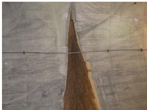
漏水しています。
