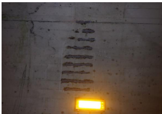
鉄筋が露出しています。
