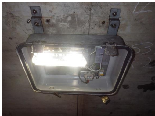
照明灯具本体が破損しています。
