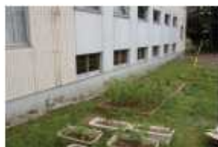
入船中学校武道館(摩擦杭、地盤改良なし) 中学校校舎に対して約80mm沈下
