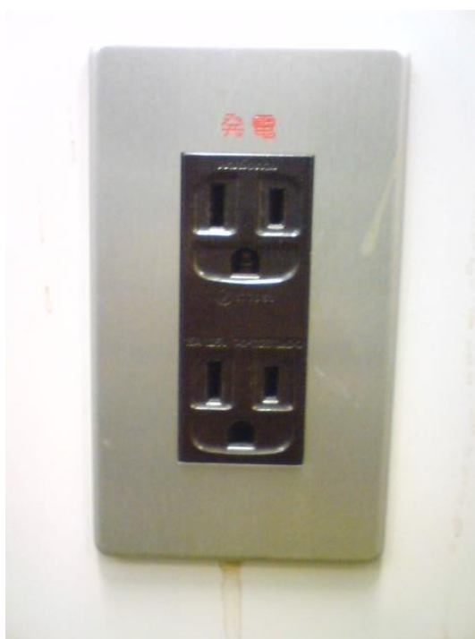
図4-1 非常用発電機から電力供給を受けるコンセント 注)コンセント部分が濃茶色のものが停電時に 非常用発電機から電力供給を受ける。
