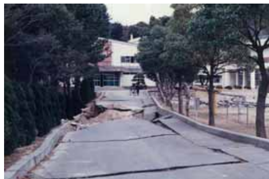
72. 道路の破壊（1987年千葉県東方沖地震）
