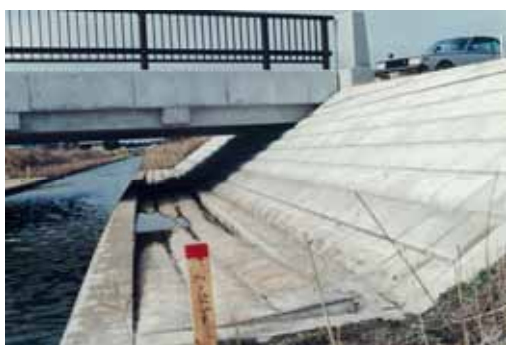
71. 堤防の破壊（1987年千葉県東方沖地震）
