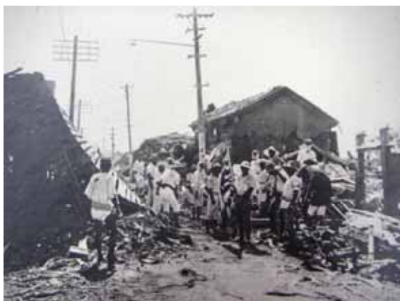
35. 道路補修作業の様子 (館山市立博物館蔵 震災写真集より) 現在のように大型重機がない当時は、ほとんど人力に頼って復旧工事が行われました。
