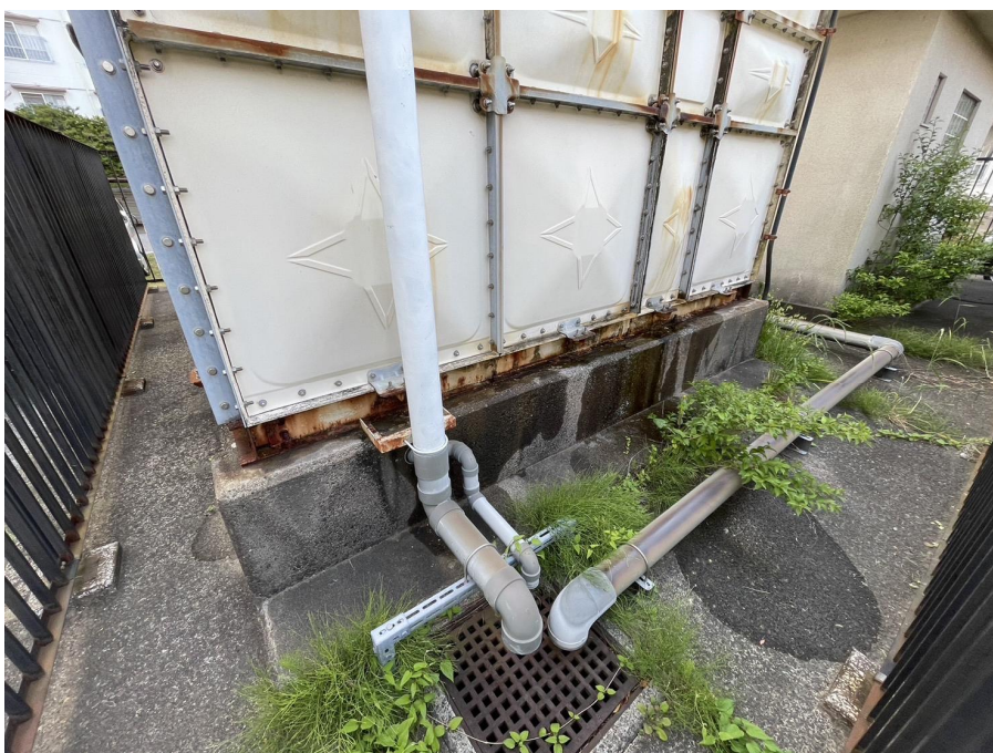
受水槽の水漏れ
