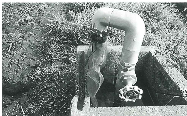
写真1 ネットが設置されている水口
