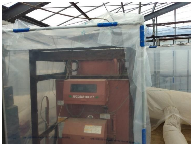
写真1 暖房機による外気導入
