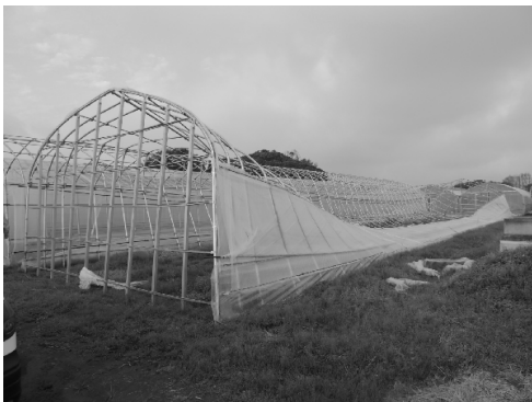
倒壊したハウス
