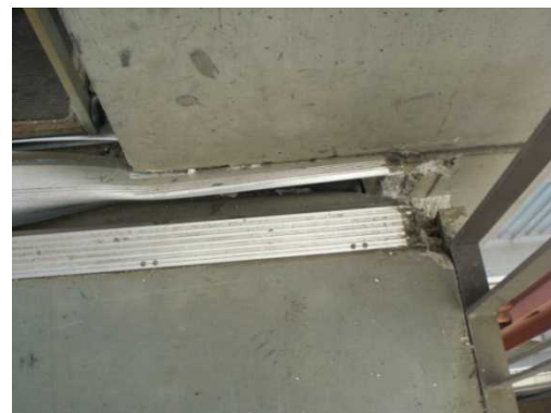
③校舎エクステンション破損
