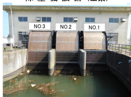
除塵機設備（全景）
