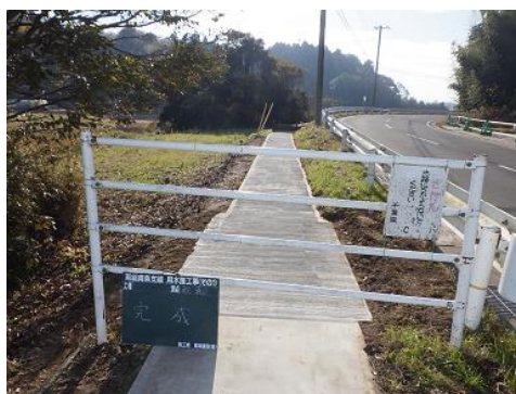
用水管理設（開水路内）
