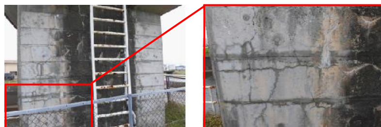
門柱 変色・ひび割れ
