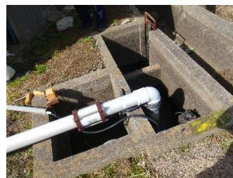
水中ポンプ（更新前）
