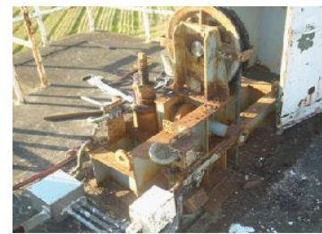
開閉装置の劣化
