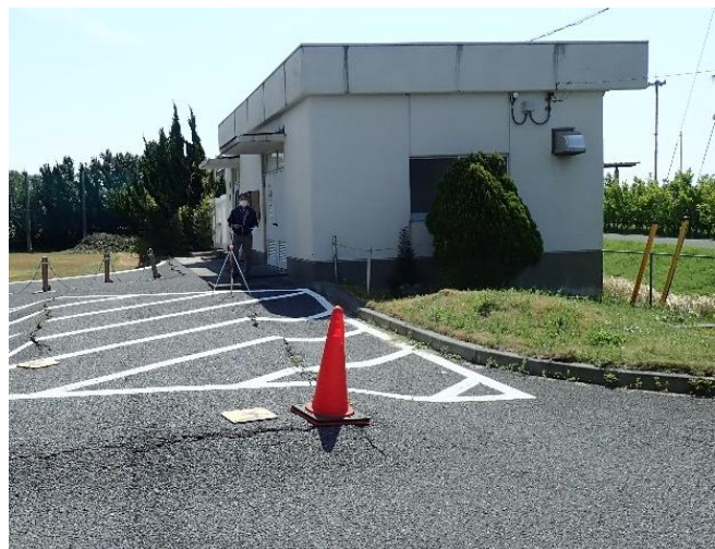
図2 給水・給電用のボックスカルバートの抜け上がりの被害状況。
