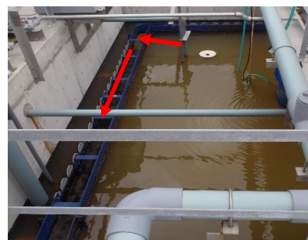
写真 3 沈殿槽 （赤矢印：上澄みの水が堰を超えて流れ出る）
