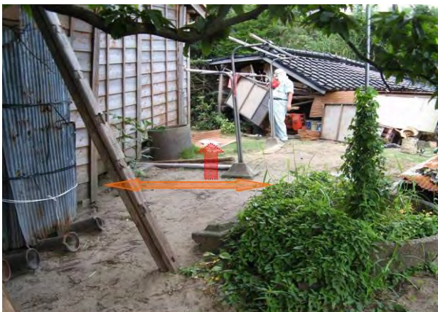
図 3 図 1 の Ph3 地点の写真 (隆起に伴い手前の家屋は傾き, 奥の小屋は倒壊した。)
