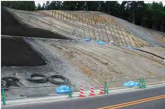
図4 長岡市大積千本町付近の国道8号線沿いの斜面崩壊(北緯37度24分51秒, 東経138度42分47秒付近)
