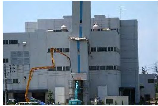
図7 柏崎市山本の市清掃工場煙突の破断(北緯37度23分38秒, 東経138度35分2秒付近)
