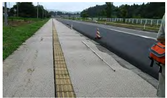
図10 柏崎市堀付近の県道73号線の波長2m程度の波状変形(北緯37度19分56秒, 東経138度34分55秒)
