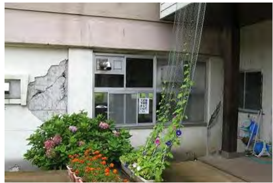
図8 長岡市小国町七日町の下小国小学校における鉄筋コンクリート製柱・壁の破断(北緯37度19分27秒, 東経138度43分1秒付近)
