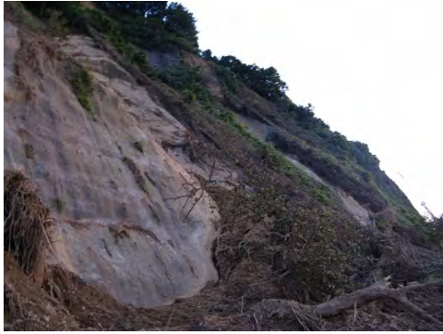
図3 柏崎市観音岬付近での斜面崩壊(北緯37度29分2秒, 東経138度37分12秒)
