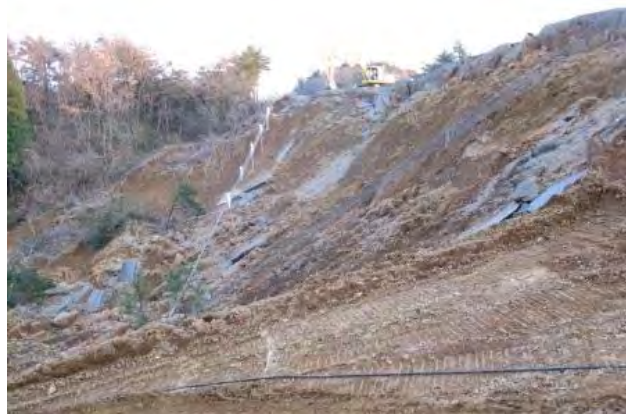
図 4 能登有料道路別所岳 P A 南東の斜面崩壊（谷頭部の盛土部分が崩壊した）
