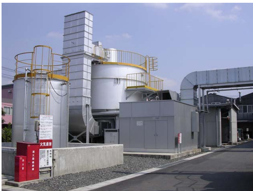
図. 3 導入蓄熱式排ガス燃焼装置 (左手前は灯油タンク)
