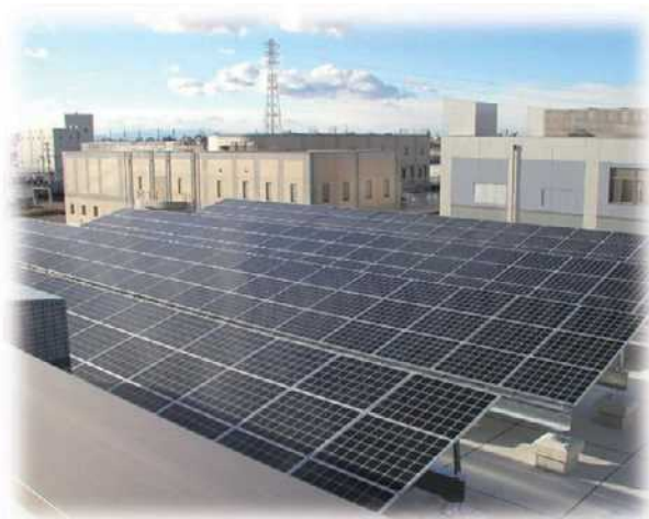
ちば野菊の里浄水場太陽光パネル
