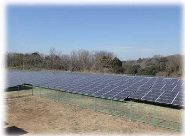
袖ヶ浦浄水場メガソーラー
