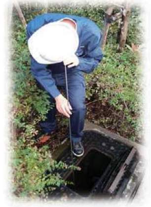
漏水調査：水道管から伝わる音だけをたよりに漏水を見つけます。
