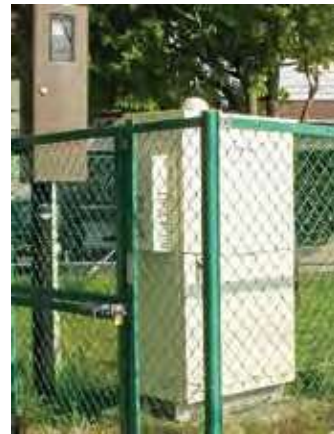
図5－10 水質自動監視装置
