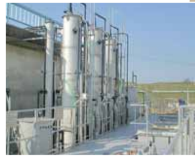
高度浄水処理施設
