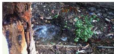
地上にでてきた漏水
