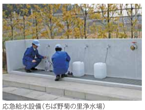
応急給水設備(ちば野菊の里浄水場)
