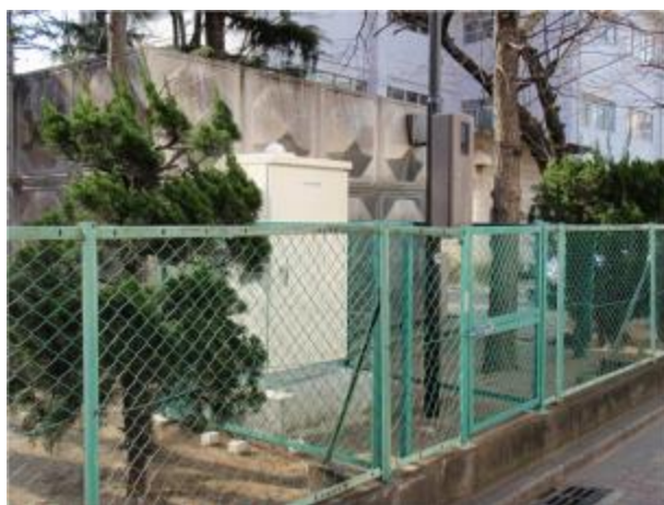
図 1-1-1 水質自動監視装置の外観
