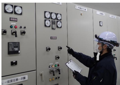
図6 電気設備の日常点検
