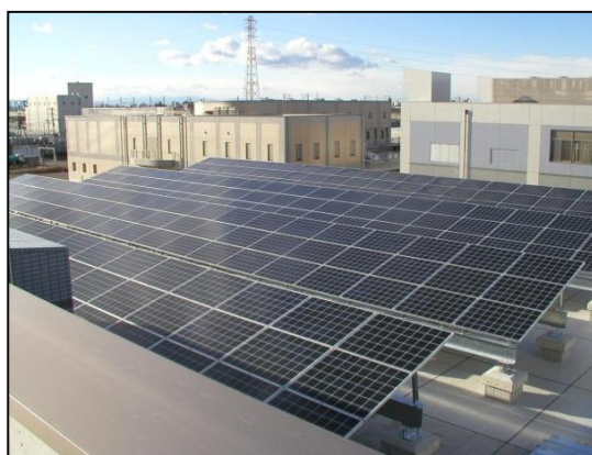
図 1 6 太陽光発電パネル（ちば野菊の里浄水場）
