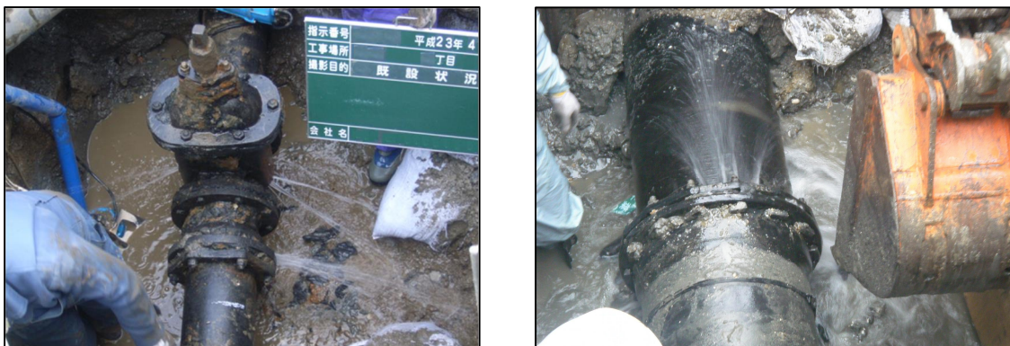
図15 東日本大震災の液状化で漏水した管路
