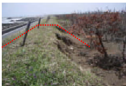
土塁の裏法損傷（旭市三川）
