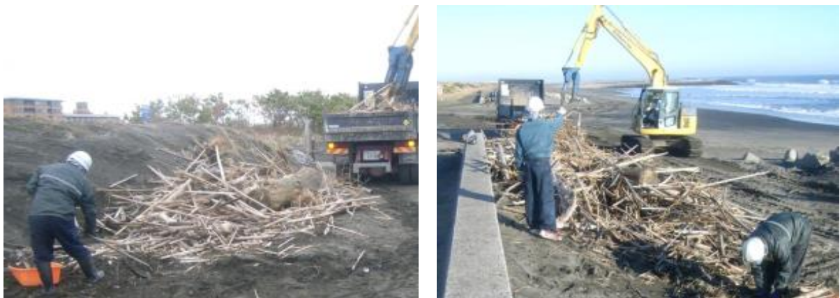
図 6－28 重点区域の様子（一宮町） （令和元年 1 1 月）
