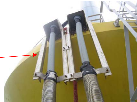
海底ケーブル固定用鋼材変形
