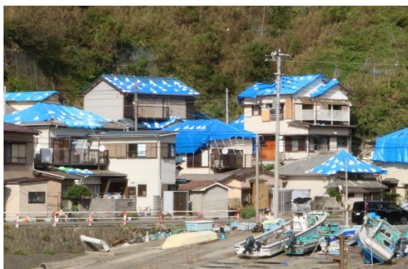
写真 9-3 令和元年房総半島台風
