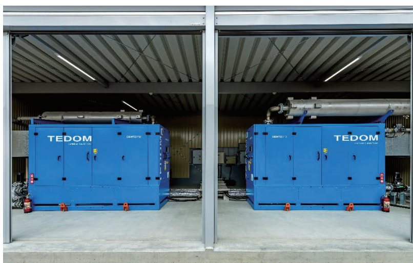
写真-参 10-6 むつざわスマートウェルネスタウンの発電機
