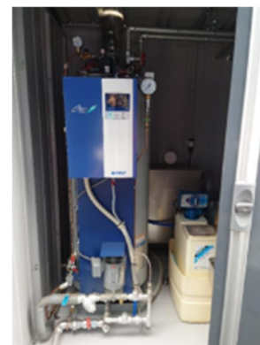
蒸気ボイラー
