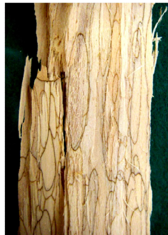
写真3 腐朽材にあらわれた雲形の帯線
