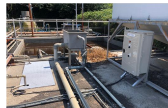
汚泥自動制御装置
