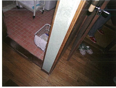
●改善前：洗面所入口
