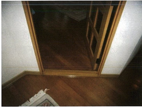
●改善前：ドア下枠の段差
