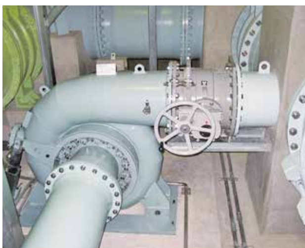
マイクロ水力発電設備（妙典給水場）
