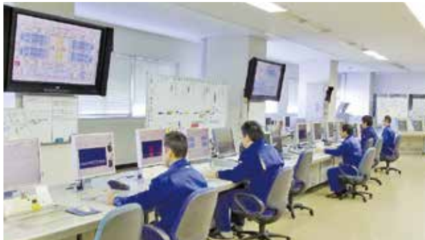
柏井浄水場 中央管理室
