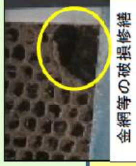
壁等の破損修繕
