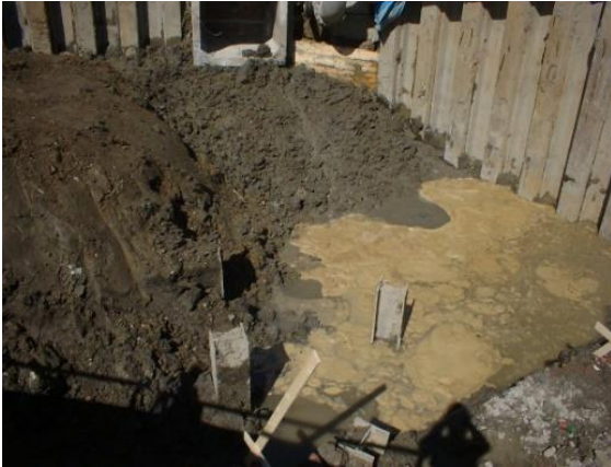
【イメージ】盤ぶくれによる泥水噴出
