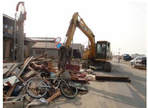
（主）飯岡一宮線 倒壊物撤去
