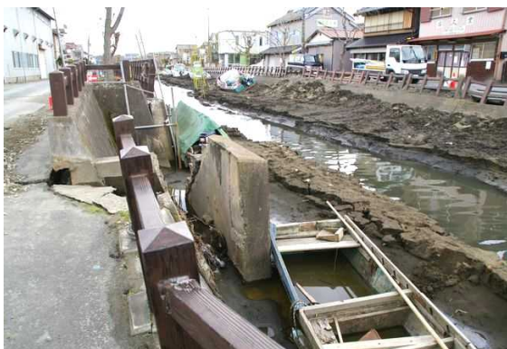
液状化と側方流動による噴砂と護岸倒壊・小野川(香取市)
