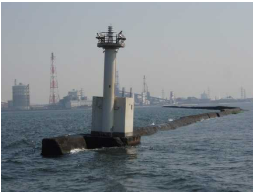
堤防の沈下（被災状況）
