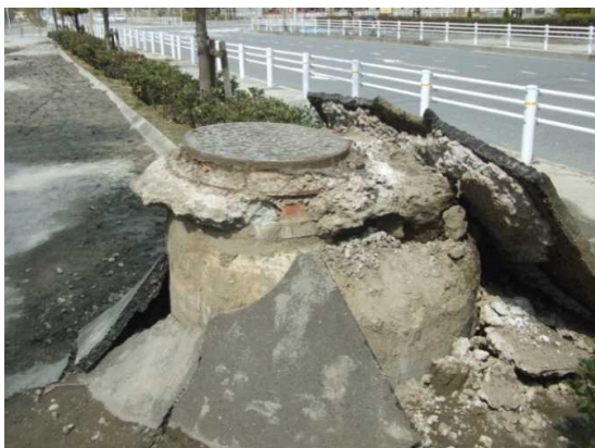
マンホールの異常隆起(浦安市)
