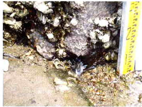
代表的な腐食状況 (穴あき)
