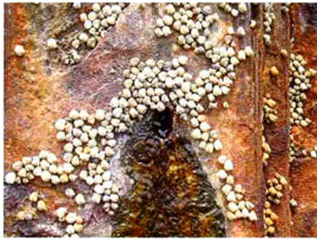
代表的な腐食状況 (穴あき)
