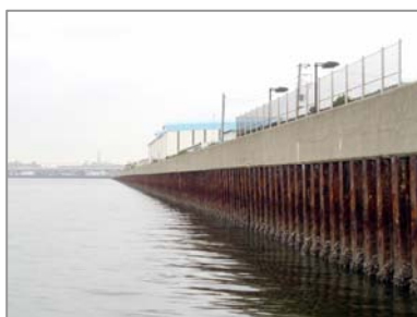
改修前の直立護岸
