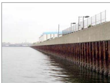
改修前の直立護岸
