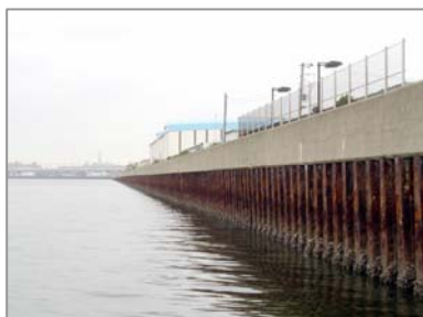
改修前の直立護岸
