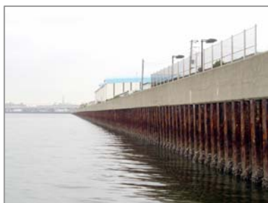
改修前の直立護岸
