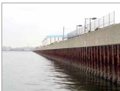
改修前の直立護岸
