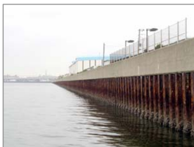
改修前の直立護岸
