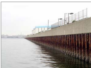
改修前の直立護岸
