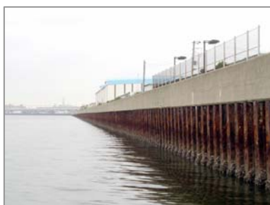
改修前の直立護岸
