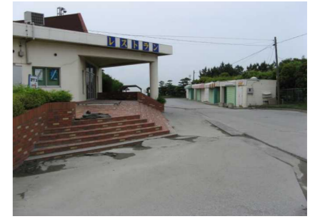
施設が一部損壊
